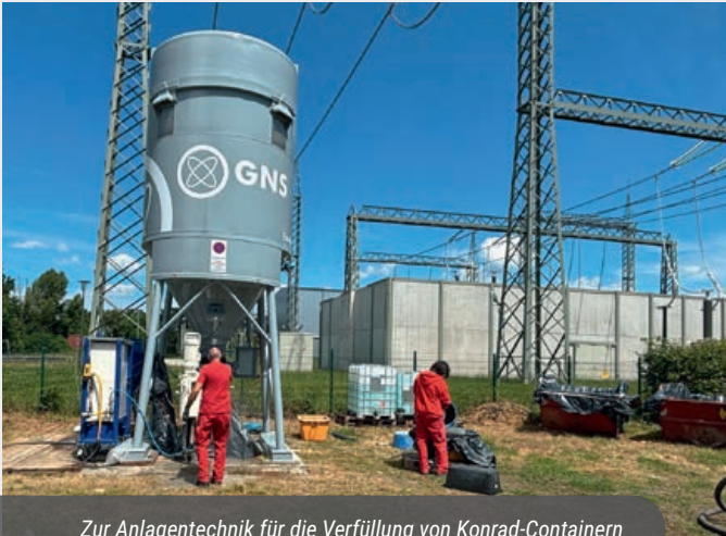
Zur Anlagentechnik für die Verfüllung von Konrad-Containern gehören auch GNS-eigene Betonsilos.
